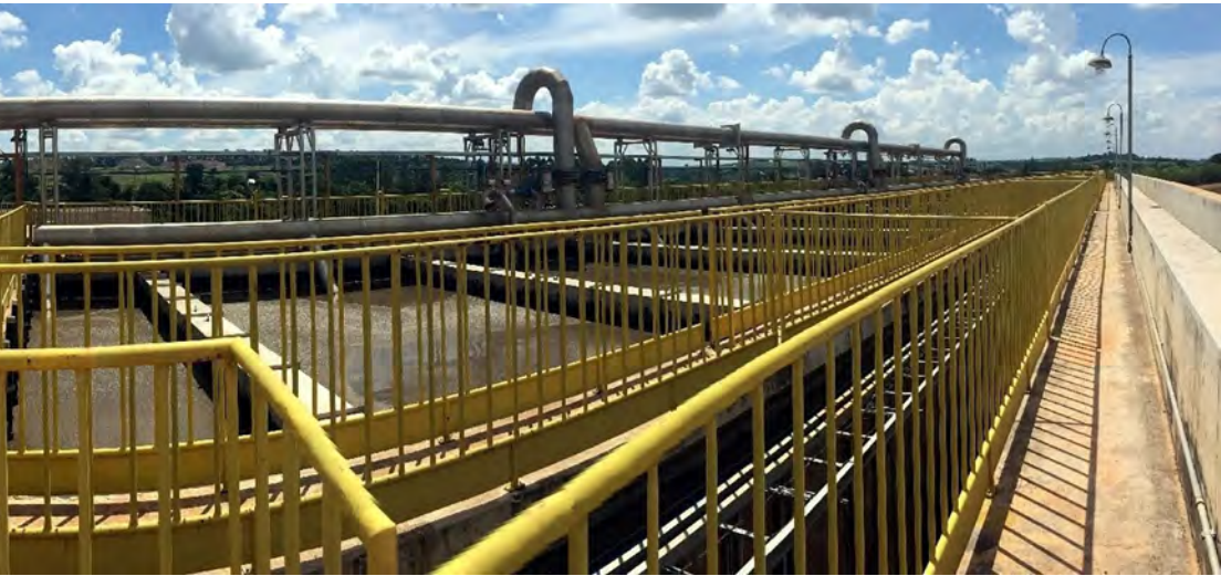
A ETE do Jardim Novo em Rio Claro
