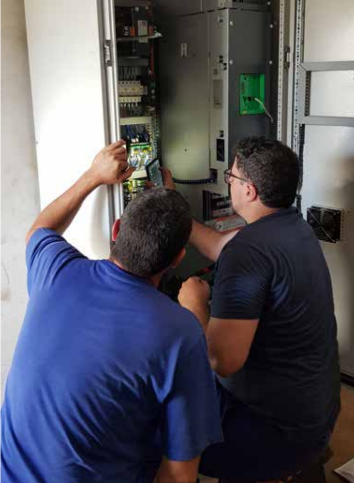
Equipamento reduz custo de energia na operação de fornecimento de água, melhora a vazão e pressão e evita desperdício de água
