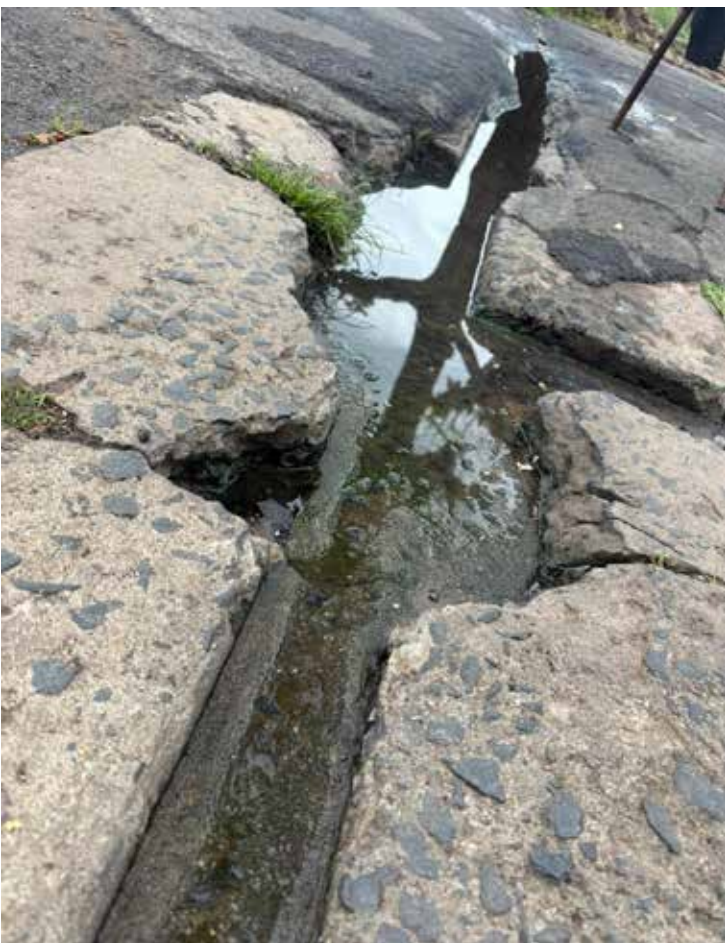
Edivane caiu em buraco dentro de uma valeta na Rua 17, esquina com a Avenida 34
