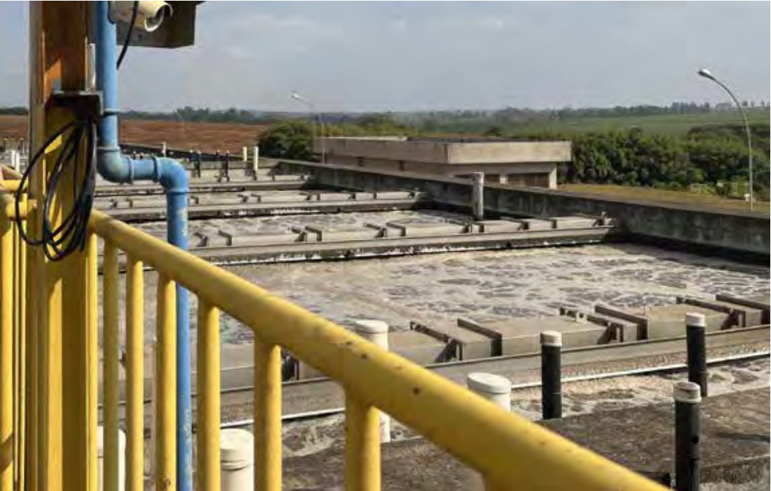
Estação de Tratamento de Esgoto Jardim Novo utiliza o sistema Nereda
