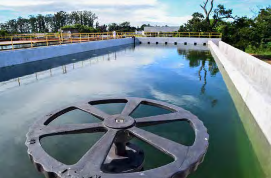
A ETA 2, no rio Corumbataí, garante 60% do abastecimento da cidade
