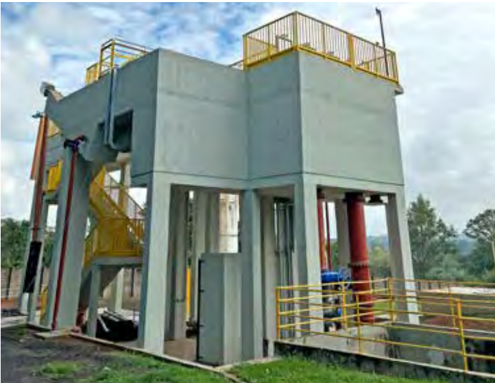
A unidade é responsável pelo tratamento de cerca de 7,8 milhões de litros de efluentes por dia
