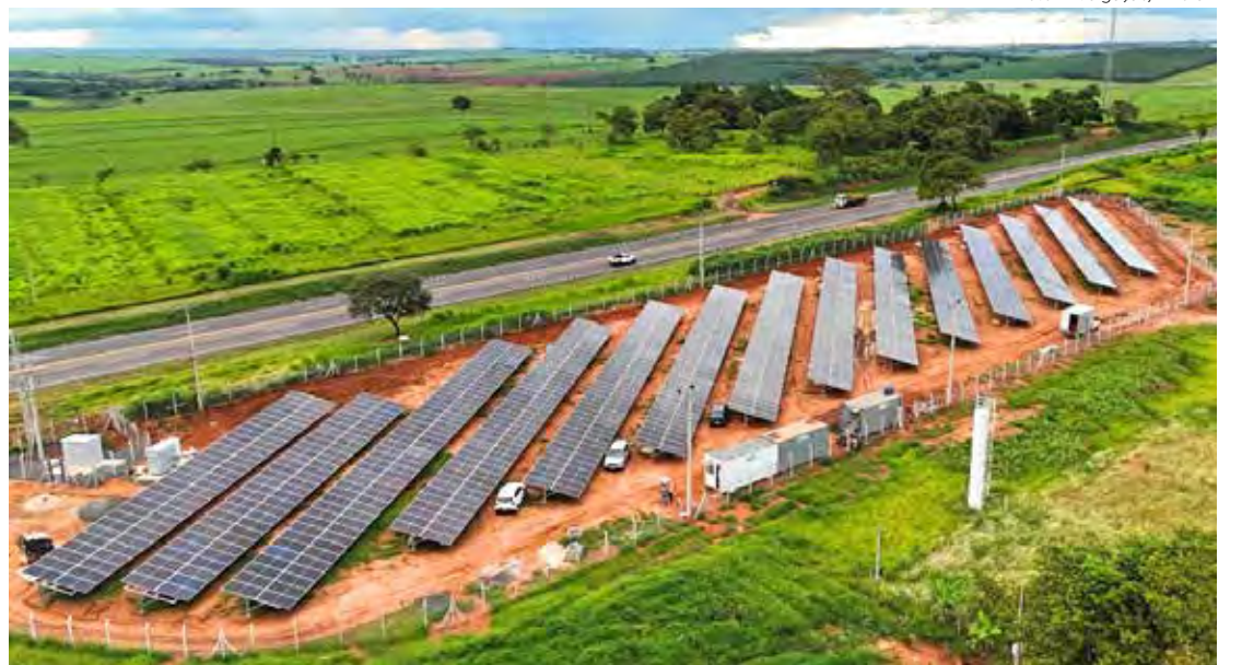
A Eixo SP instalou em Parapuã (na SP-294, km 553) a sua maior usina solar fotovoltaica, com 1.200 placas de energia limpa
