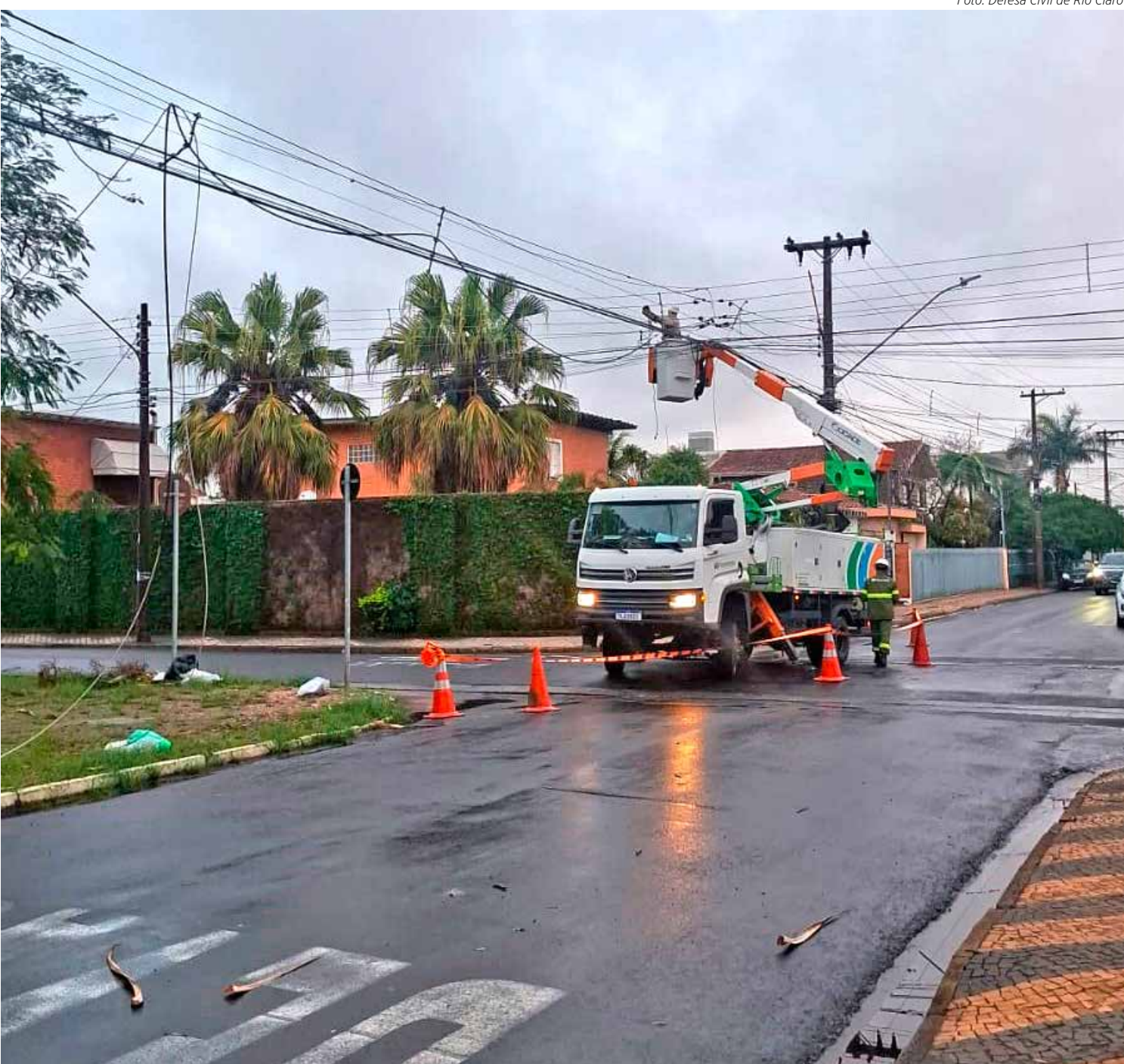
Na quinta-feira (10), chuvas com ventos de até 70 km/h atingiram Rio Claro causando quedas de árvores e prejuízos materiais
